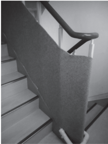
写真 4. K 仮園舎の階段 手すりの間の隙間が広く、転落の危険があるため、覆いをしている。
