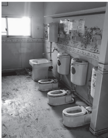
写真1. 被災した園舎内のトイレ 床や壁には泥が流れ込んだ後が残っている。何度拭いてもカビが発生してしまう。
