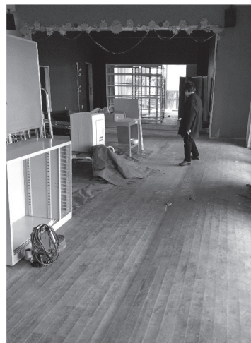
写真2. ホールの床 水や泥をかきだし、乾かした後も床が水を含み、波打っている。
